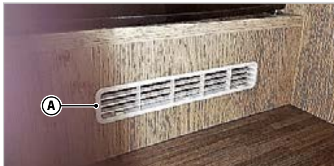
Rys.6.1 - Stałe otwory wentylacyjne
