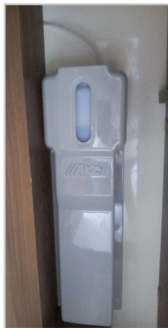
Fig.6.41 - Niveau du mélange de glycol
